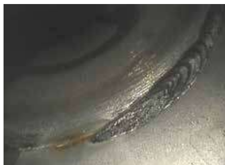
Billede 2. Endoskopi foretaget i rør med dårlige svejsninger. NDT med endoskopi viser, at det er en dårlig håndvejst svejsning.
